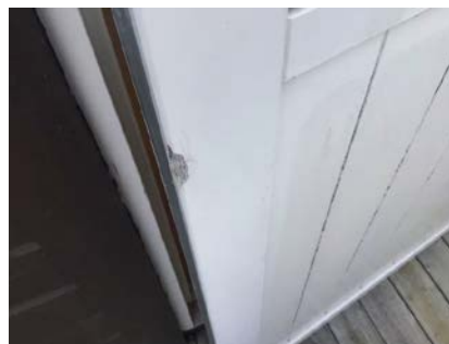
merke på balkongdør 2 etg.
