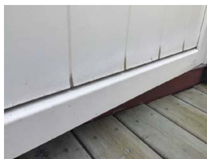
fuktskade på balkongdør 2 etg.
