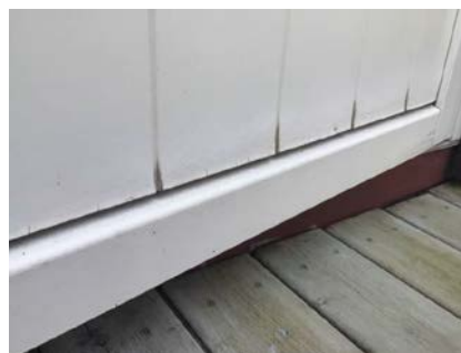
fuktskade på balkongdør 2 etg.
