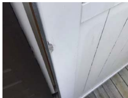
merke på balkongdør 2 etg.
