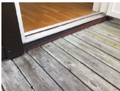
løst beslag under balkongdør 2 etg.
