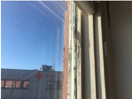
Råteskade på omramning og isolerglass er løst.
