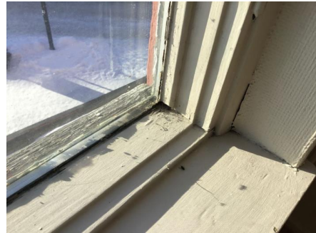
Kondensmerker på flere vinduer.
