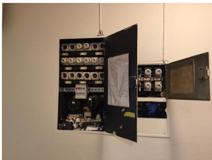
Sikringsskap plassert i gang.
