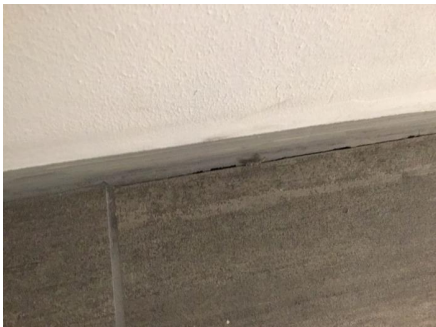
Sprekker i elastiske fuger.
