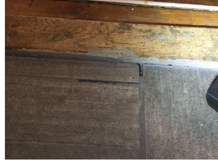
Ufullstendig fugging av fliser på gulv.
