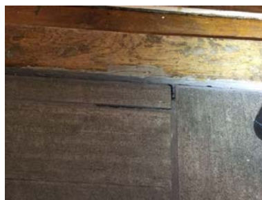
Ufullstendig fuging av fliser på gulv.
