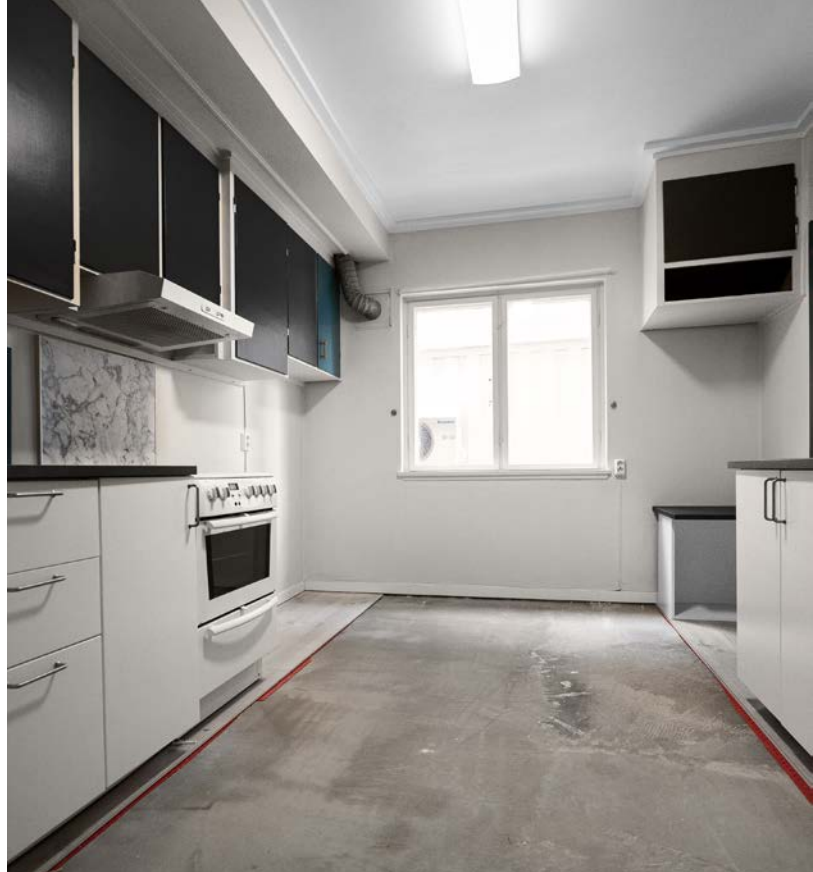
Separat kjøkken med behov for oppgraderinger.
