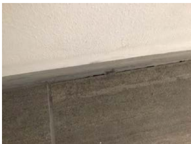
Sprekker i elastiske fuger.
