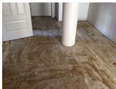
Overflater er fjernet på flere gulv.
