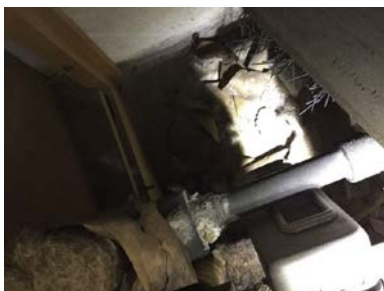
Irr og drypplekkasje fra vannrør på bod.
