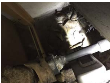
Irr og drypplekkasje fra vannrør på bod.
