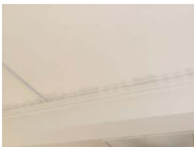
Heksesot eller støvkondens på flere overflater.
