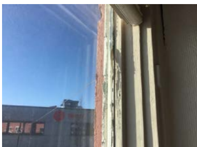
Råteskade på omramning og isolerglass er løst.
