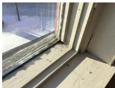
Kondensmerker på flere vinduer.
