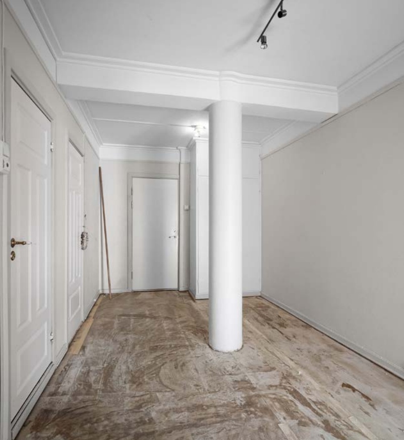
Leilighet har tidligere hatt vannskade og overflater på gulv ble fjernet i flere rom. Det er nå lagt nytt gulv.
