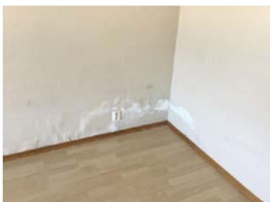
Saltutslag på vegger registrert. Ved fuktsøk ble det registrert unormale verdier. Fuktskjolder i himling.
