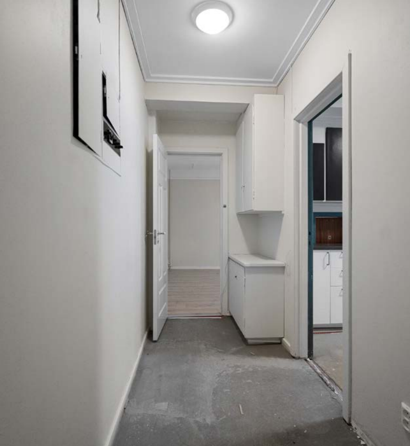
Elektrisk anlegg med skrusikringer. Det elektriske anlegget er gammelt og bør oppgraderes.
