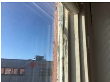
Råteskade på omramning og isolerglass er løst.
