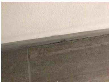
Sprekker i elastiske fuger.
