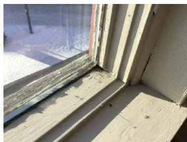
Kondensmerker på flere vinduer.
