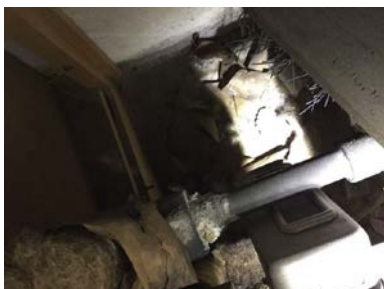
Irr og drypplekkasje fra vannrør på bod.
