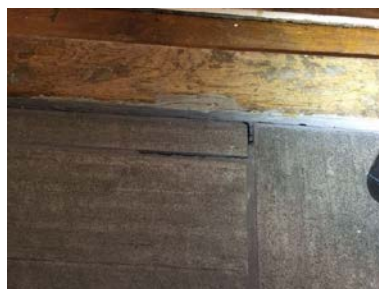
Ufullstendig fuging av fliser på gulv.
