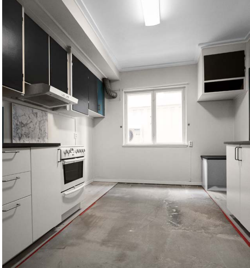
Separat kjøkken med behov for oppgraderinger.
