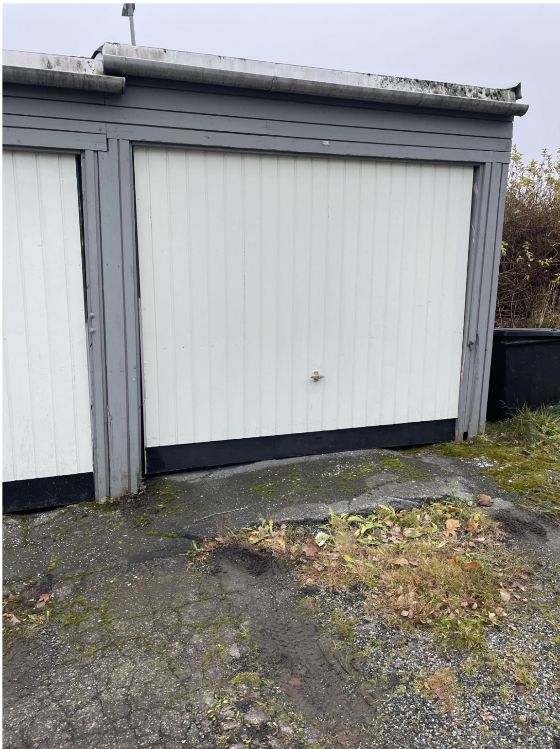
Tydelig setningsskader foran og inne i garasjer.
