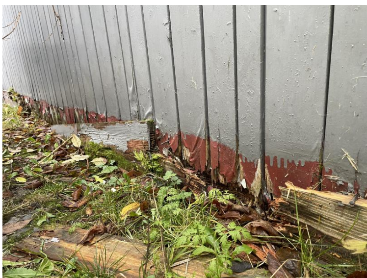
Gjennomgående råteskader i bunn av kledning og sviller.
