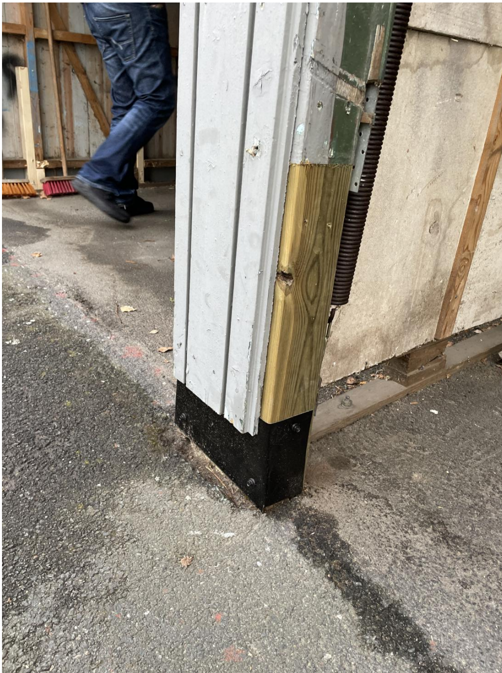
Beslag kan beskytte treverket og utsette utviklingen av råteskader.
