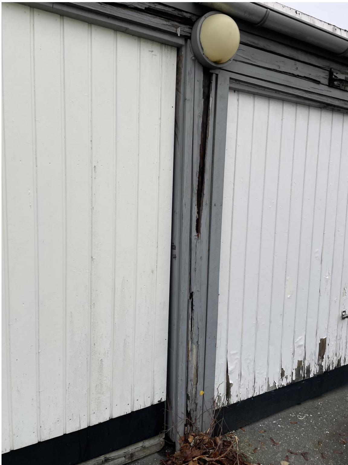
Råteskadet garasjeporter, kledning og bærekonstruksjon.
