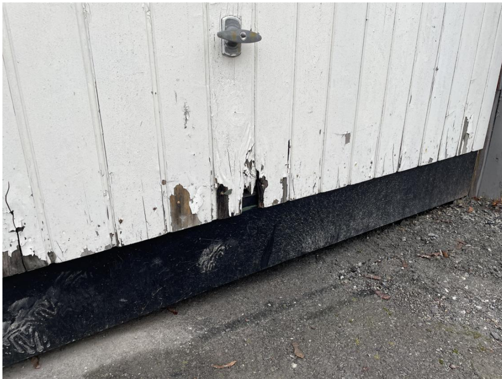
Hull i garasjeport på grunn av råteskader.
