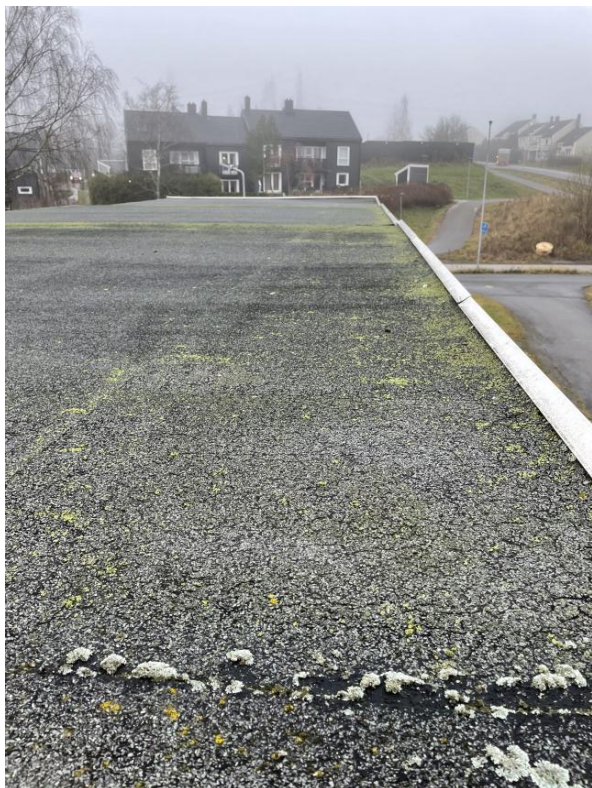
Papptekke på garasjer. Fremstår som oppsprukket og med organisk begroing. Papptekking er 35 år og har en normal levetid på 25 år.
