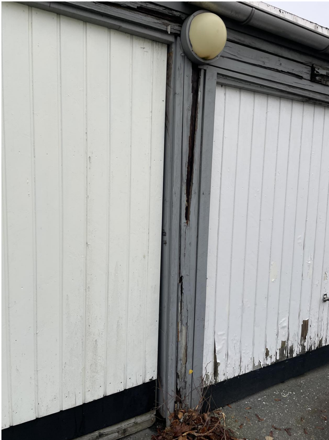
Råteskadet garasjeporter, kledning og bærekonstruksjon.
