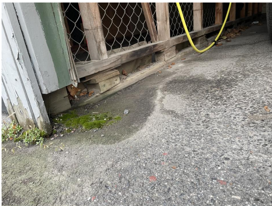
Bæresøyle mellom porter er sunket gjennom årene. Medfører at det blir en svanke i terrenget for fukt samler seg og trekker videre inn i bæresøyler.
