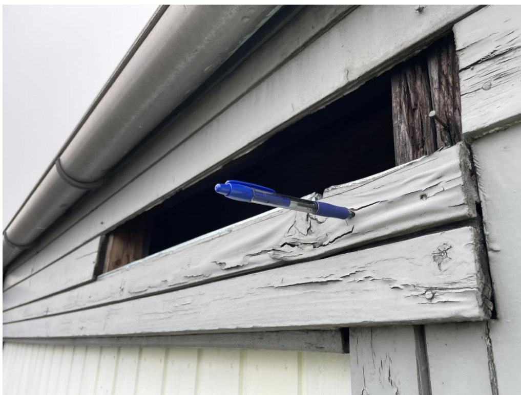
Råteskadet kledning og bærekonstruksjon også høyt oppe på yttervegger.
