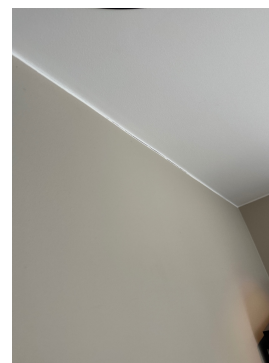
Liten sprekke dannelse i overgang vegg og tak i stue. Dette er helt normalt, da det er trebygg.
