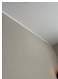
Liten sprekke dannelse i overgang vegg og tak i stue. Dette er helt normalt, da det er trebygg.
