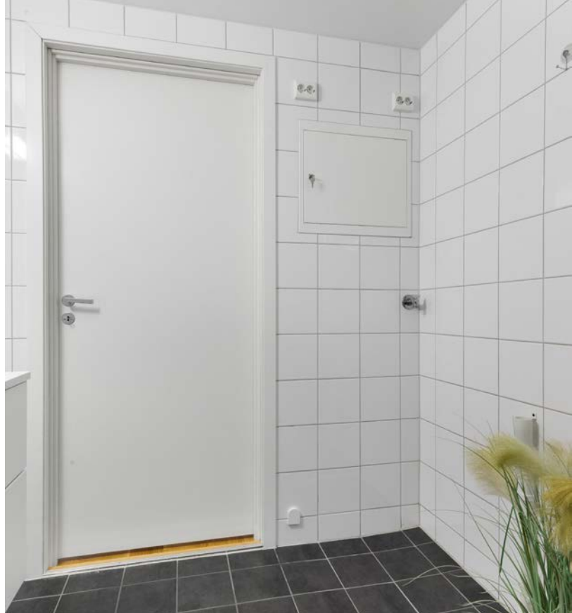
Opplegg til vaskemaskin og tørketrommel.
