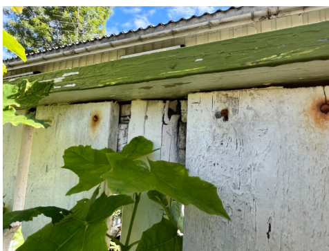
Råteskader i rekkverk.
