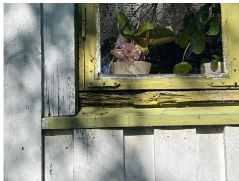
Vinduer med råteskader
