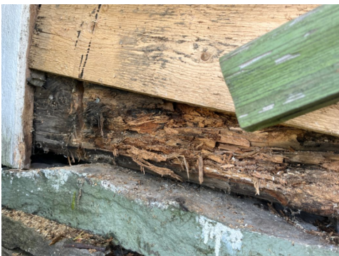
Råteskade i konstruksjon
