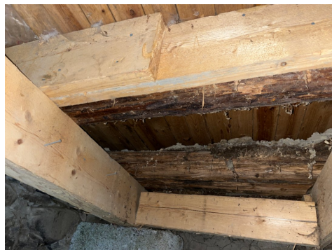
Råte i gamle bjelker.
