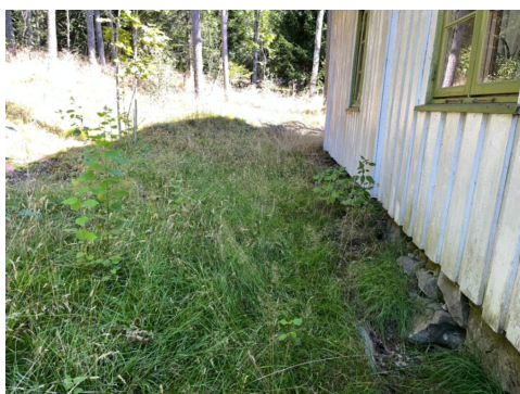
Terrengfall mot grunnmur.
