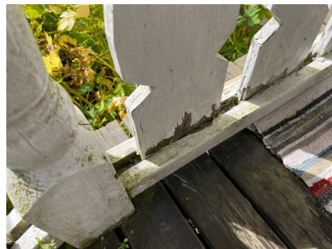
Råteskade i rekkverk
