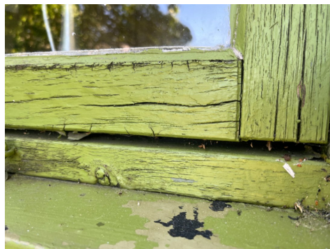
Værslitte, sprukket treverk.
