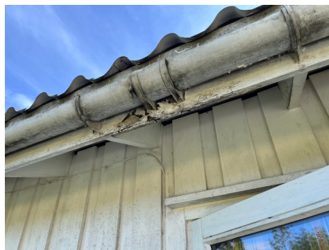
Lekkasje i skjøt
