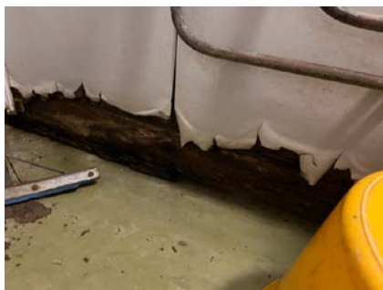
Råteskader i plater vaskerom
