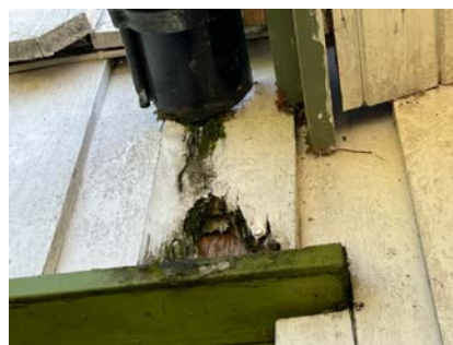
Manglende tetting i ende av takrenne
