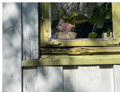
Vinduer med råteskader
