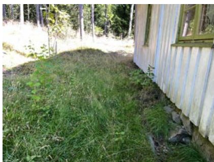
Terrengfall mot grunnmur.
