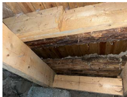
Råte i gamle bjelker.
