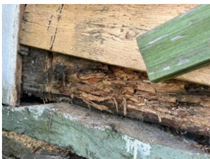
Råteskade i konstruksjon
