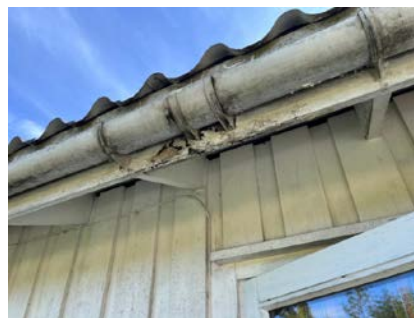
Lekkasje i skjøt
