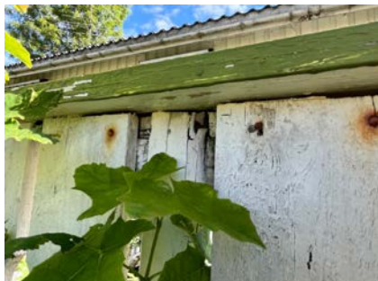
Råteskader i rekkverk.
