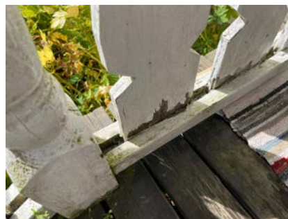
Råteskade i rekkverk
