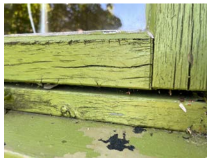
Værslitte, sprukket treverk.
