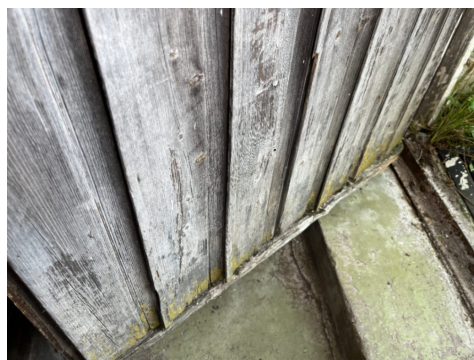
Råteskader i nedre kant av dør.
