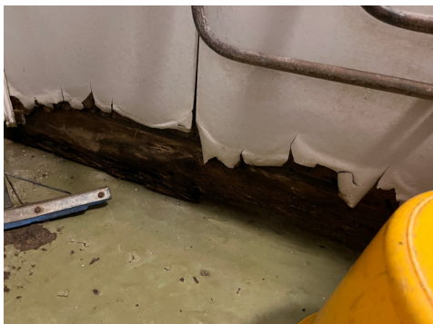
Råteskader i plater vaskerom
