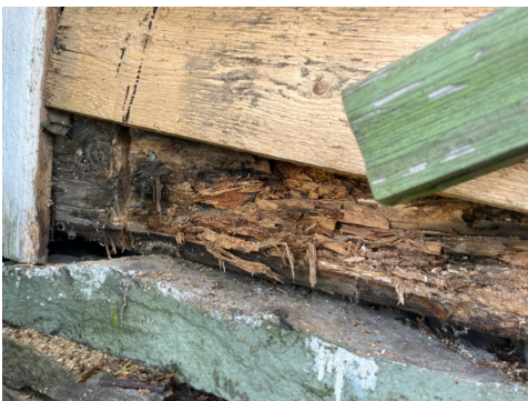
Råteskade i konstruksjon
