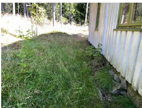
Terrengfall mot grunnmur.
