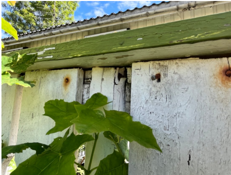
Råteskader i rekkverk.
