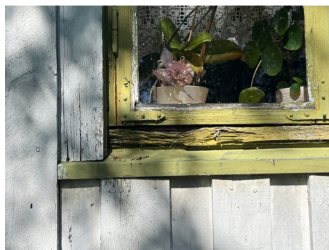
Vinduer med råteskader
