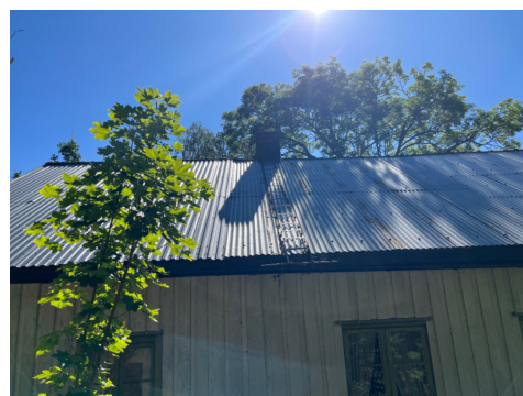
Løs takstige og manglende takrenner.
