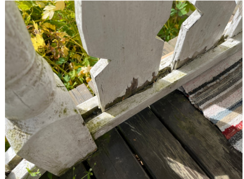
Råteskade i rekkverk
