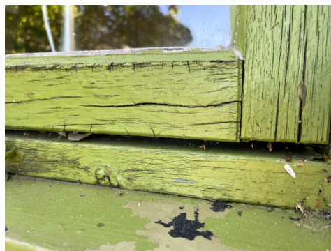
Værslitte, sprukket treverk.
