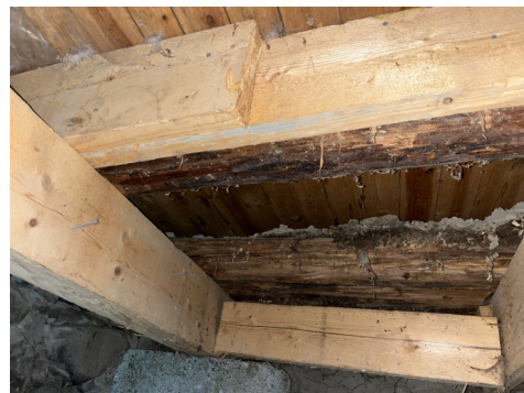
Råte i gamle bjelker.
