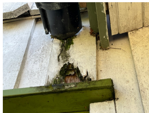
Manglende tetting i ende av takrenne
