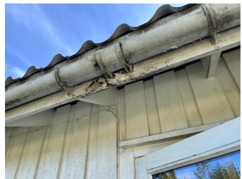
Lekkasje i skjøt
