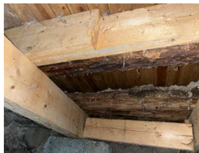
Råte i gamle bjelker.
