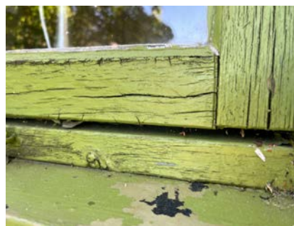
Værslitte, sprukket treverk.
