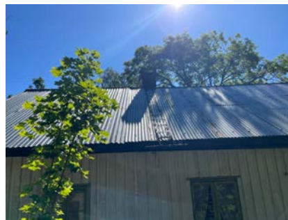
Løs takstige og manglende takrenner.
