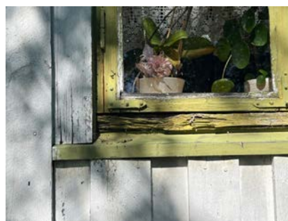
Vinduer med råteskader
