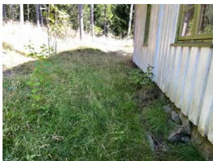
Terrengfall mot grunnmur.
