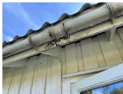
Lekkasje i skjøt
