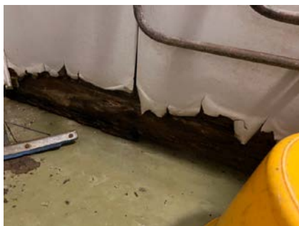
Råteskader i plater vaskerom
