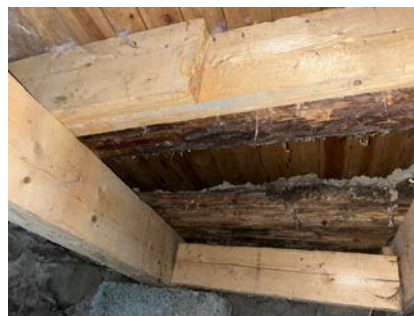
Råte i gamle bjelker.
