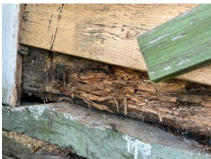
Råteskade i konstruksjon
