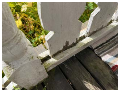
Råteskade i rekkverk
