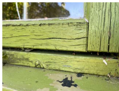
Værslitte, sprukket treverk.
