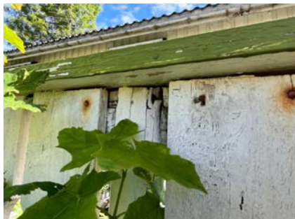
Råteskader i rekkverk.
