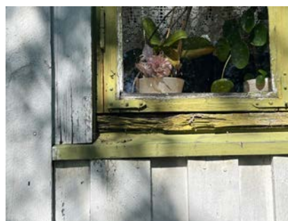
Vinduer med råteskader
