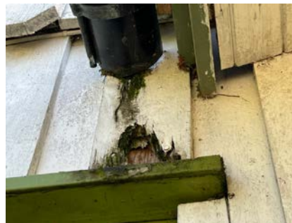
Manglende tetting i ende av takrenne
