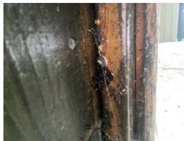
Litt lite lufting bak kledning
