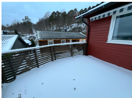
Dagens krav for rekkverk er 100 cm.
