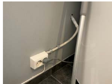
Ikke fagmessig utført elektrisk.
