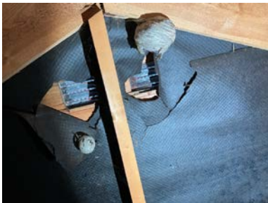
Ny netting bør monteres.
