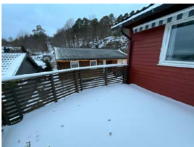
Dagens krav for rekkverk er 100 cm.
