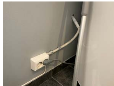
Ikke fagmessig utført elektrisk.
