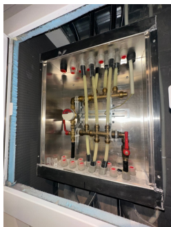
Samleskap med rørkurser og stoppekraner
