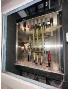
Samleskap med rørkurser og stoppekraner
