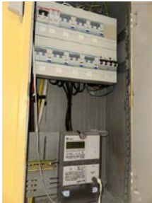
Sikringsskap med automatsikringer.
