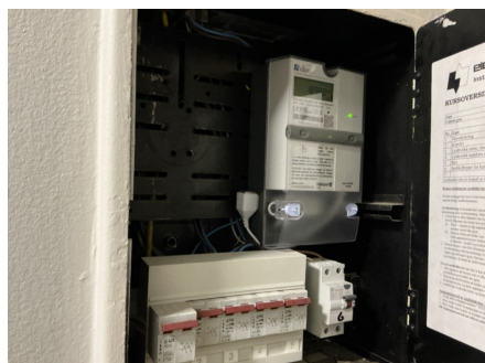
Automatsikringer i sikringsskap plassert i gang/fellesareal.
