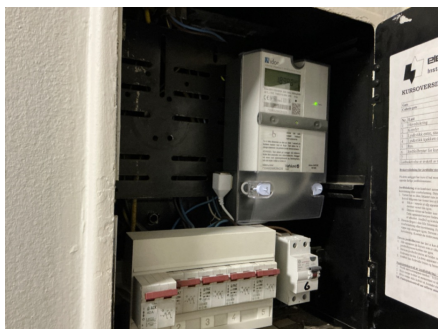
Automatsikringer i sikringsskap plassert i gang/fellesareal.
