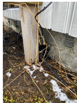
ingen synlig tettesjikt, mur mot kjeller.
