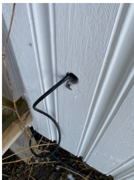
Det er påvist ledninger som ikke er tilstrekkelig festet.
