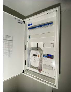
Sikringsskap med automatsikringer, plassert i gangen i loftsetasjen.
