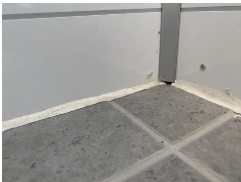
Manglende tetting mellom vegg/gulv.
