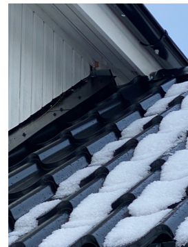
Det er påvist avvik i beslagløsninger mot veggkonstruksjon.
