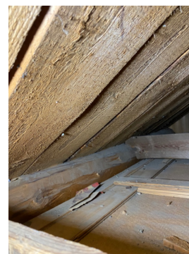
Ingen synlig dampsperre i etasjeskillet.
