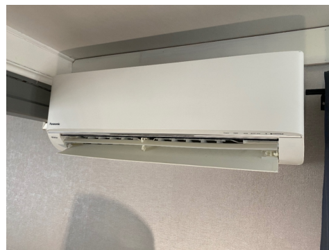
Varmepumpe innvendig del.
