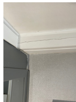
Gulvåser har stedvis sprekker.
