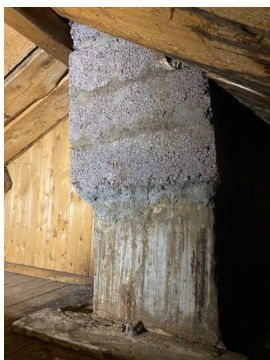
Sotvann fra pipe, skjevheter i påstøpt del over tak
