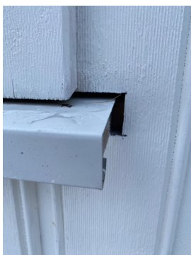
Åpninger mot vannbrett bør tettes.
