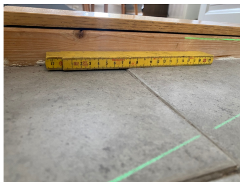
Fliser er stedvis ujevne i skjøter, det er registrert bom i flis.
