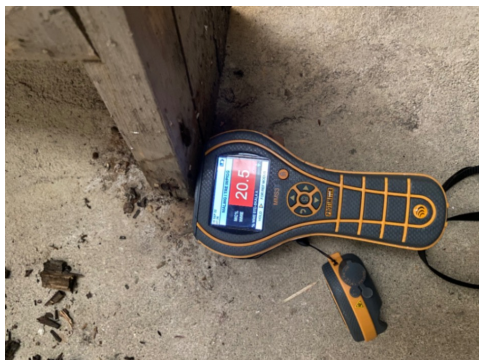
Det er registrert fukt og råteskader i trapp mot gulvet.
