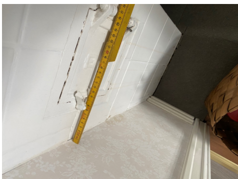
Det er påvist brennbar materiale nærmere enn 300 mm fra sotluke/feieluke.
