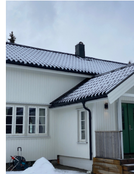
Det mangler snøfangere på taket, noe som var krav på byggemeldingstidspunktet.
