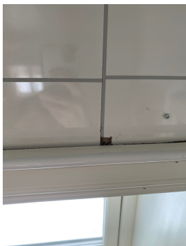
Synlige skruer, ujevne plateskjøter, hakk i plater.
