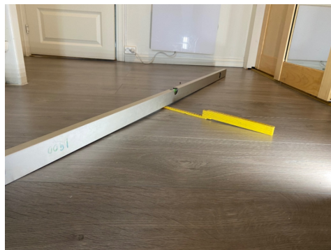
Skjevheter, gulv i gangen.
