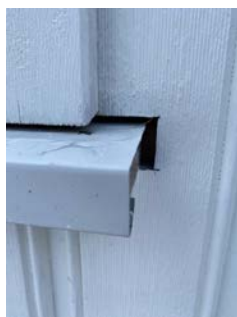
Åpninger mot vannbrett bør tettes.
