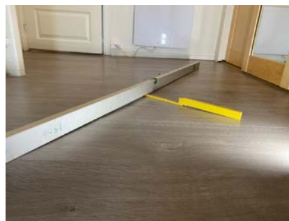
Skjevheter, gulv i gangen.
