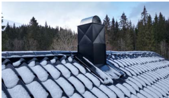
Pipehatt. Det mangler tilfredsstillende adkomst til pipe for feier.
