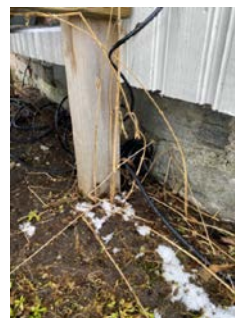
ingen synlig tettesjikt, mur mot kjeller.
