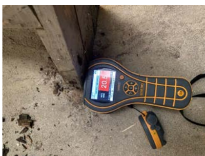
Det er registrert fukt og råteskader i trapp mot gulvet.
