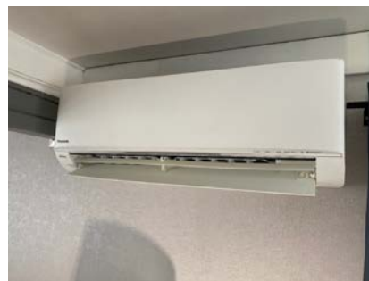
Varmepumpe innvendig del.
