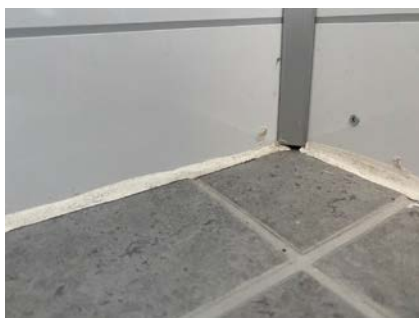
Manglende tetting mellom vegg/gulv.
