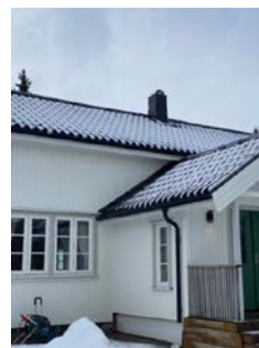
Det mangler snøfangere på taket, noe som var krav på byggemeldingstidspunktet.
