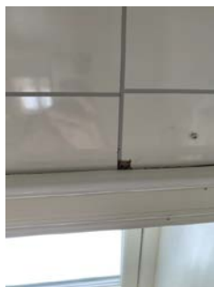
Synlige skruer, ujevne plateskjøter, hakk i plater.
