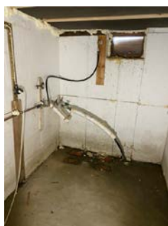
Kjeller. Det er påvist synlig fuktighet på gulv i kjeller.
