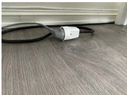
Bruk av skjøteledning.
