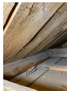
Ingen synlig dampsperre i etasjeskillet.
