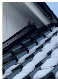
Det er påvist avvik i beslagløsninger mot veggkonstruksjon.
