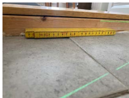
Fliser er stedvis ujevne i skjøter, det er registrert bom i flis.
