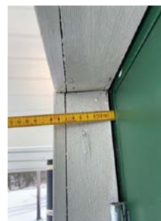
Glippe mot karm, utvendig omramming.
