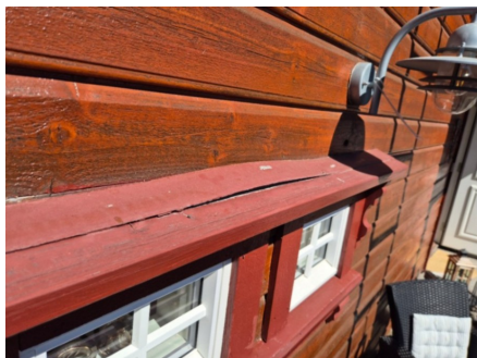
Løst beslag over kjøkkenvinduer.
