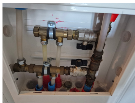
Rørfordelerskap til leilighet.
