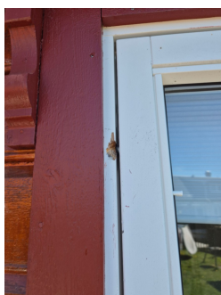
Punktvis skader i terrassedør etter lås i dørblad.
