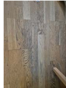
Bruksslitasje på soveromsgulv.
