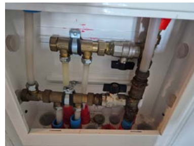
Rørfordelerskap til leilighet.
