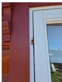
Punktvis skader i terrassedør etter lås i dørblad.
