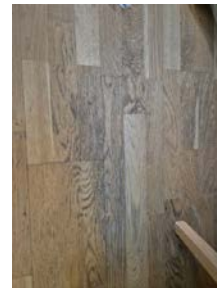
Bruksslitasje på soveromsgulv.
