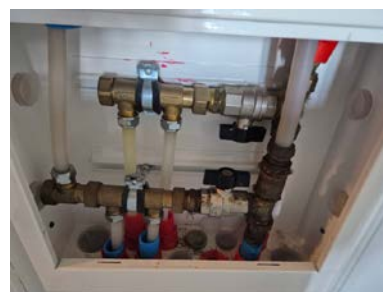
Rørfordelerskap til leilighet.
