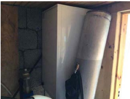
Varmtvannstank på vegg.
