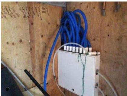
Skap til rør i rør system.
