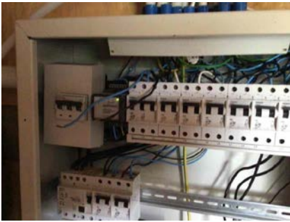
Del av sikringsskap.
