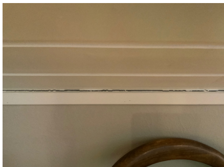
Sprekk mellom list og skråtak i loftsetasje
