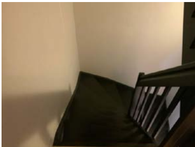
Mangler håndløper i trappeløp.
