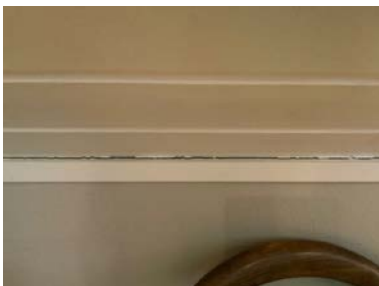
Sprekk mellom list og skråtak i loftsetasje
