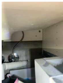
Det er ikke tettesjikt rundt avløpsrør under servant.
