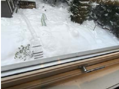
Kondens på et vindu i loftsetasjen.
