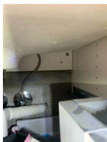
Det er ikke tettesjikt rundt avløpsrør under servant.
