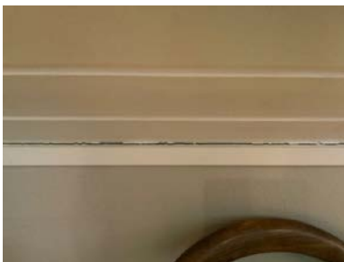
Sprekk mellom list og skråtak i loftsetasje
