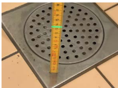
Fallforhold ca. 135 mm topp slukrist i dusjsone
