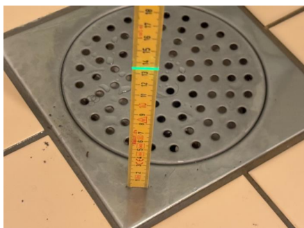
Fallforhold ca. 135 mm topp slukrist i dusjsone
