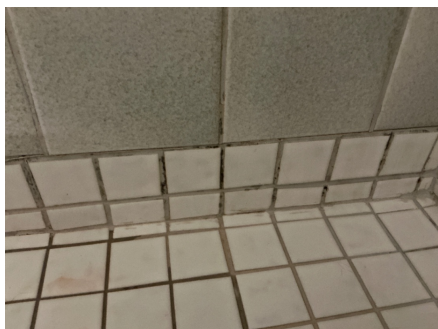
Svertesopp på fuger.
