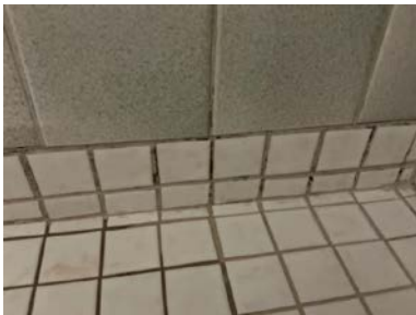
Svertesopp på fuger.
