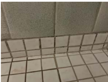
Svertesopp på fuger.
