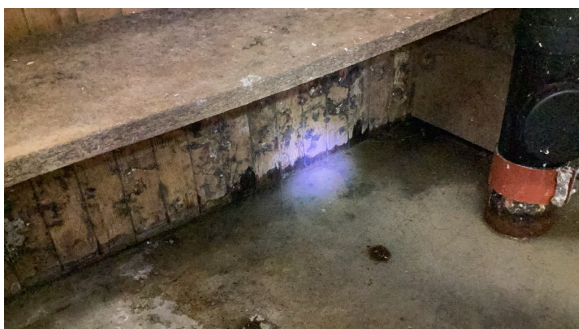
Fuktopptrekk i delingsvegg.
