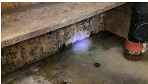
Fuktopptrekk i delingsvegg.
