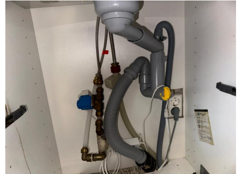
Rørproppleg i kjøkkenbenk med Waterguard
