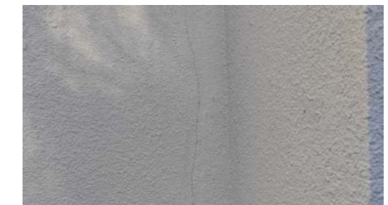
Mindre riss i mur.
