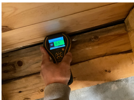
Fremstår tørt på befaringdagen.
