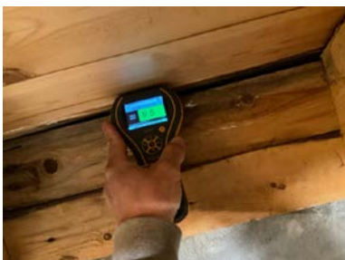
Fremstår tørt på befaringsdagen.
