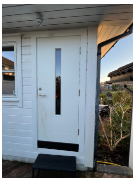
Ytterdør fra soverom 3, montert i 2023. - ikke byggemeldt
