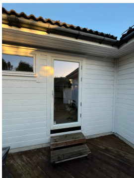
Terrassedør som er datert 2014. - ikke byggemeldt.
