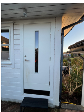
Ytterdør fra soverom 3, montert i 2023. - ikke byggemeldt
