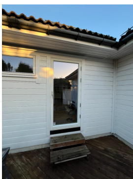
Terrassedør som er datert 2014. - ikke byggemeldt.
