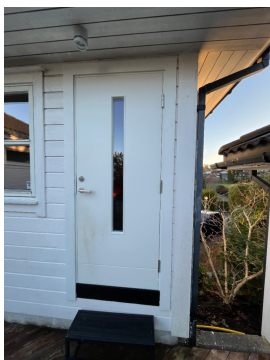
Ytterdør fra soverom 3, montert i 2023. - ikke byggemeldt
