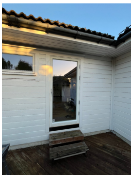
Terrassedør som er datert 2014. - ikke byggemeldt.
