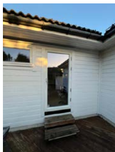
Terrassedør som er datert 2014. - ikke byggemeldt.
