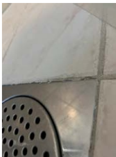
Noe riss i fuger rundt slukrist HOVEDPLAN > BAD - 4.1M2
