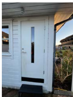
Ytterdør fra soverom 3, montert i 2023. - ikke byggemeldt
