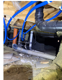
Mangler isolasjon og stubbloftplater
