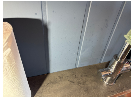
Mangler fuge mellom vegg og benkeplate. Veggoverflate er ikke fuktbestandig.
