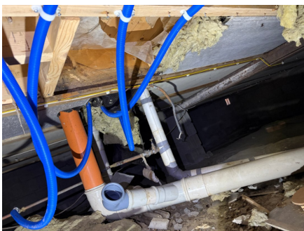
Nyere vannrør av plast.
