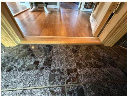
Ikke vantsett oppkant under dør.
