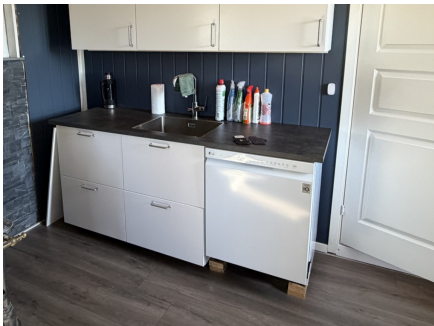
Uferdig, mangler sokler og endeplate.
