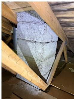
Eldre fuktmerker, misfarget bordtro
